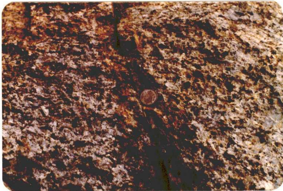
Aspecto macroscópico del granito adamellítico alterado. La alteración de la zona próxima a la fractura es mayor que la existente en el resto del granito, lo que confirma el carácter meteórico de la misma, que es mayor por lo tanto en las zonas de circulación de aguas.
